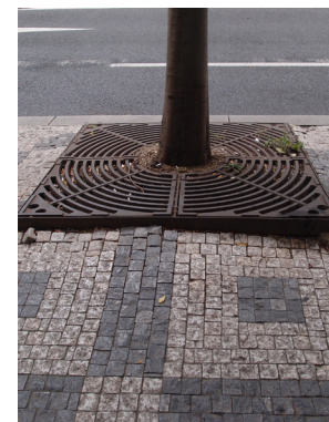
Obr. 12 Zvýšená hrana blokuje nátok vody
