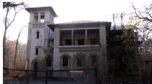
Pro neudržovaný stav hrozí zánik objektu
